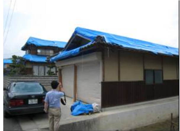
図 23 シャッターの外れ
