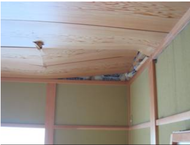
図 18 住家の1階室内の天井
