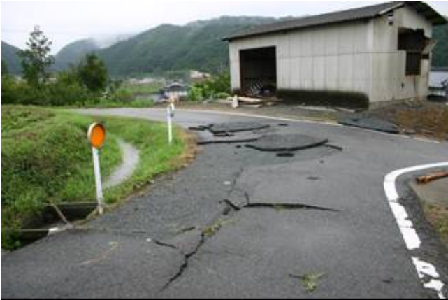
図 24 アスファルト舗装の剥離と移動 (美作市撮影)
