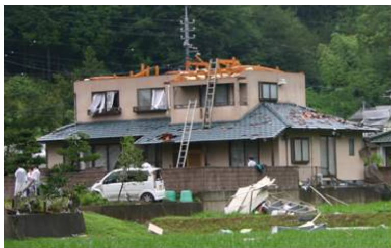
図 15 屋根が飛ばされた住家（美作市撮影）
