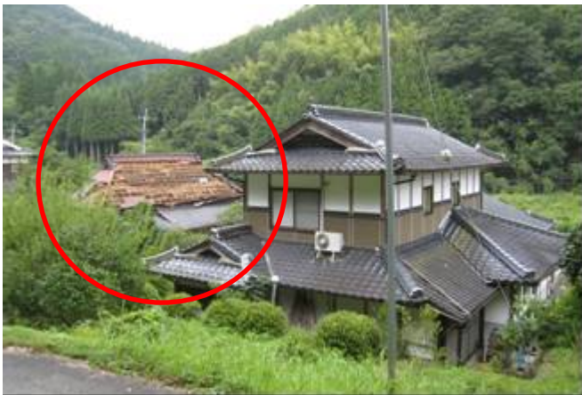
図 22 老朽化した金属製の屋根ふき材の剥離
