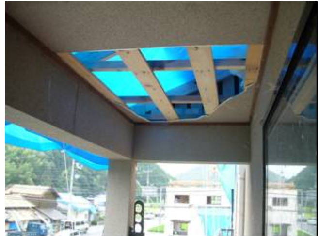
図 19 軒天井の脱落
