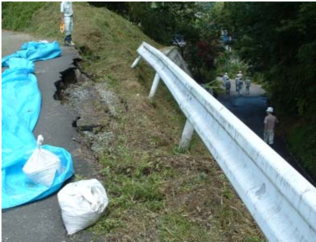
写真 - 6 松山町氷室地区で発生した道路ののり肩部の亀裂
