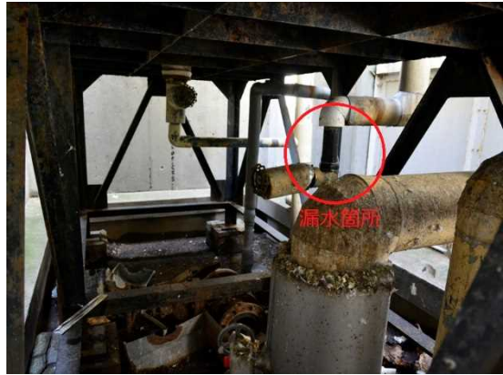
写真 5-28 別棟の高架水槽下部の配管被害
