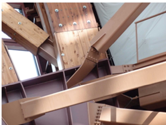
写真5-3 ガセットプレートの変形
