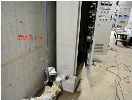
写真5-73 機械室の被害状況
