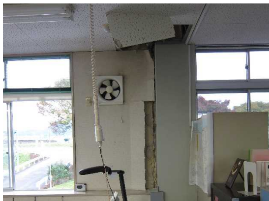
写真 5-54 エキスパンションジョイント部での天井と内装の損傷
