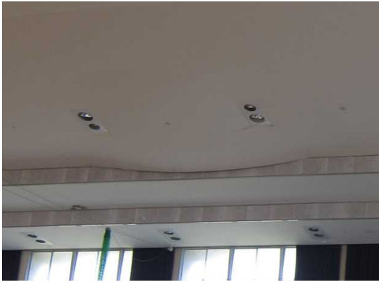
写真 5-37 天井面垂れ下がり
