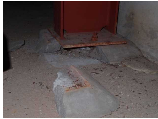
写真 5-32 モルタルの破壊
