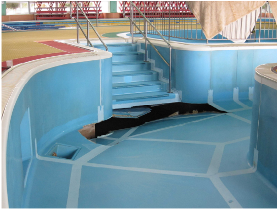
写真5-75 流水プールの底の損傷
