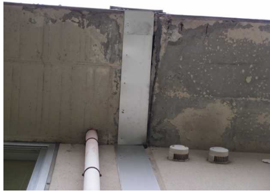
写真 5-48 南庁舎でのエキスパンションジョイント部のずれ
