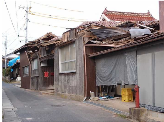
写真6-2 木造建築物の被害
