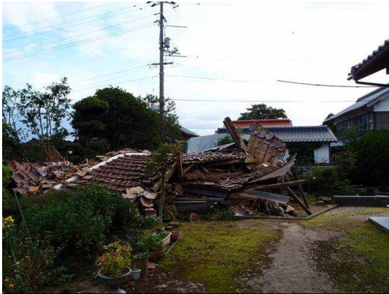
写真6-1 木造建築物の被害
