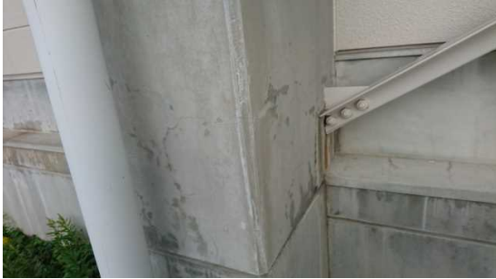
写真 5-60 柱脚部にコンクリートのひび割れ
