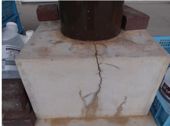
写真 5-61 柱脚部にコンクリートのひび割れ
