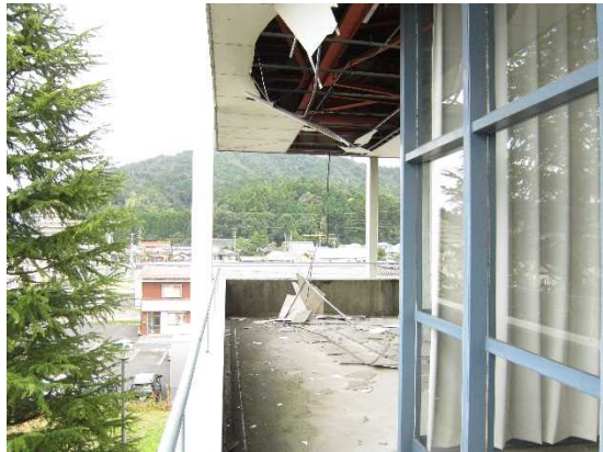
写真5-24 舞台裏の軒天井の被害
