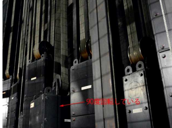
写真5-12 バトン用カウンターウェイトの被害
