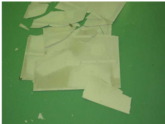
写真5-68 脱落した天井板（同）
