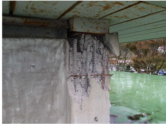
写真 5-47 鉄筋コンクリート造柱の柱頭部の破壊（外部から）
