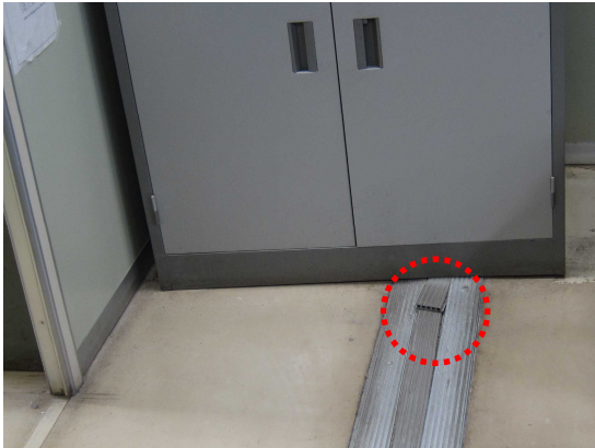
写真 5-56 エキスパンションジョイントカバーの部材の外れ
