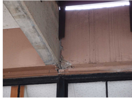
写真 5-50 梁接合部のコンクリートの剥離（既存部分）
