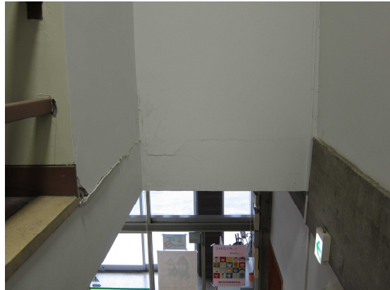
写真 5-57 階段室周りの内装のひび割れ (既存部分)
