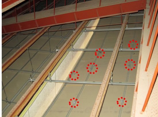
写真 5-38 天井面垂れ下がり箇所の天井裏でのクリップの外れ（赤円内が外れたクリップ）
