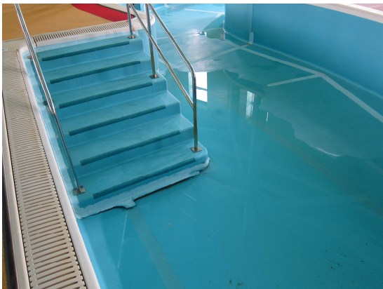
写真5-77 流水プールの底の損傷
