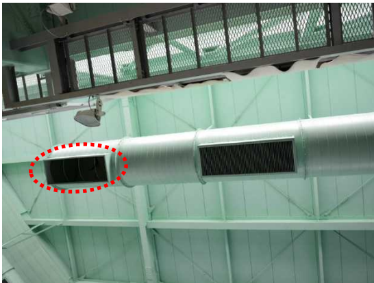
写真5-71 空調吹出し部パネルの落下
