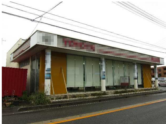
写真6-5 ガラススクリーンの被害
