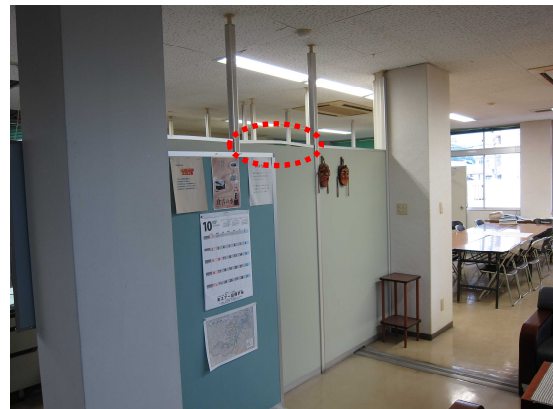
写真 5-55 エキスパンションジョイント近傍での可動間仕切りの損傷
