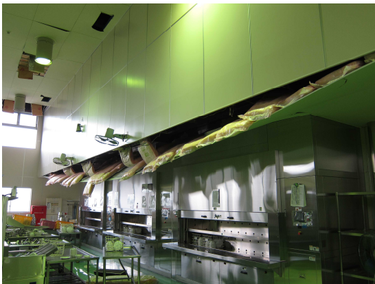
写真5-67 ダクトスペース下の天井の損傷（同）
