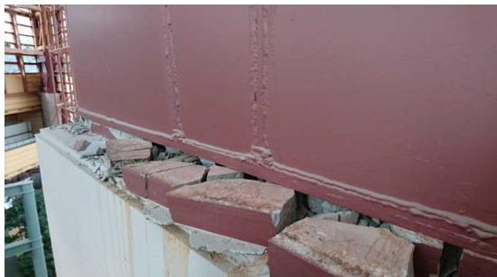
写真5-5 モルタルの破壊
