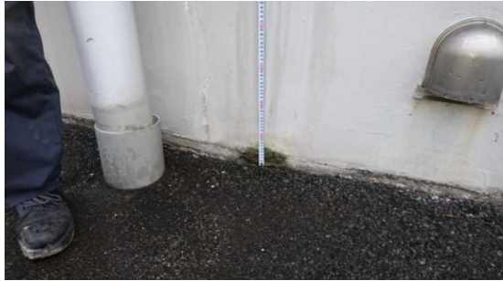
写真5-70 外壁周りでの地盤沈下
