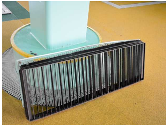
写真5-72 落下した吹出し口パネル
