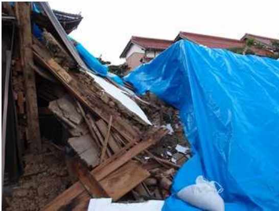
写真6-3 木造建築物の被害
