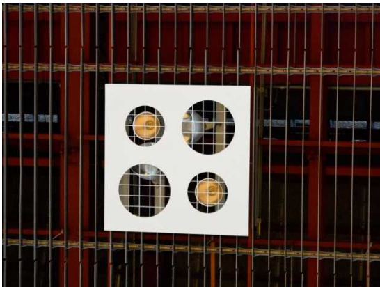
写真 5-39 天井設置の照明器具のずれ（写真内の右上と左下の照明が定位置からずれている）
