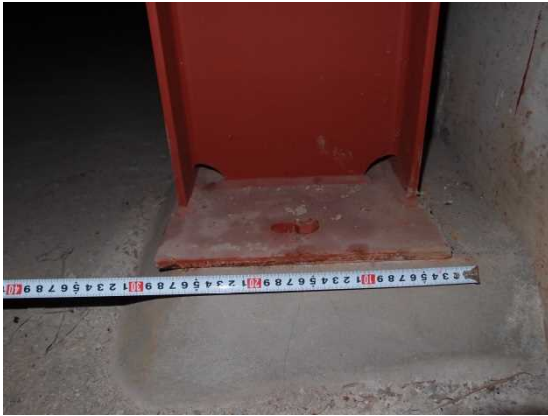
写真 5-31 鉄骨部材と鉄筋コンクリート部材の ずれ
