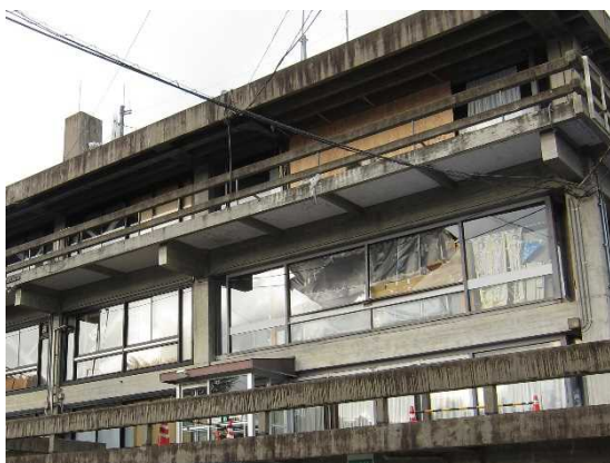
写真5-42 窓ガラスの損傷（左：無被害のアルミサッシ、右：ガラスが割れた鋼製サッシ）
