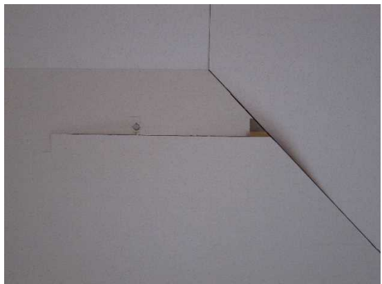
写真 5-36 天井板の外れ
