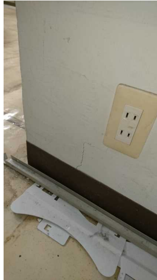
写真 5-52 鉄筋コンクリート造柱のひび割れ（既存部分）
