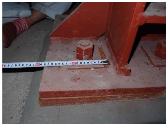
写真 5-30 鉄筋コンクリート造架構と鉄骨造トラス屋根の接合部のずれ
