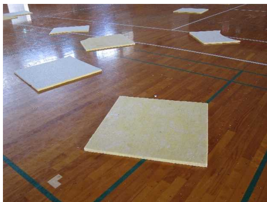
写真 5-20 脱落したガラスウール板
