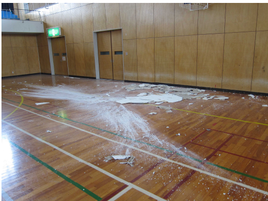
写真 5-35 脱落した天井
