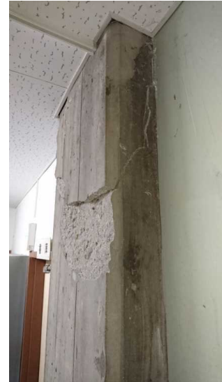
写真 5-53 柱頭部のコンクリートの剥離（既存部分）
