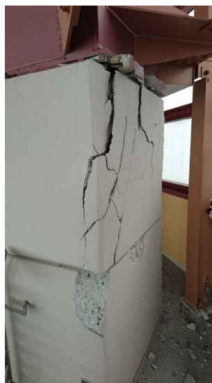
写真5-4 コンクリートの破壊
