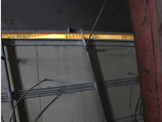
写真5-11 前写真箇所を天井裏から見る
