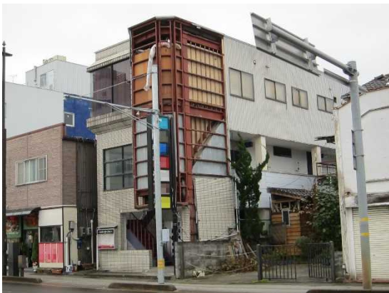
写真6-4 ラスシートモルタル外壁の脱落
