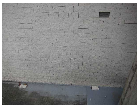
写真5-43 外壁タイルの脱落
