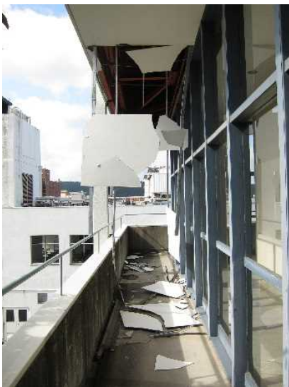
写真5-25 前写真と対角位置での軒天井の被害
