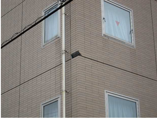
写真 6-6 PC カーテンウォールの欠け
