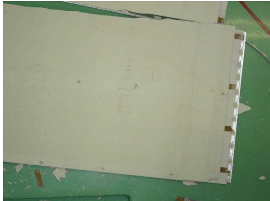
写真 5-63 脱落した壁ボード（同）
