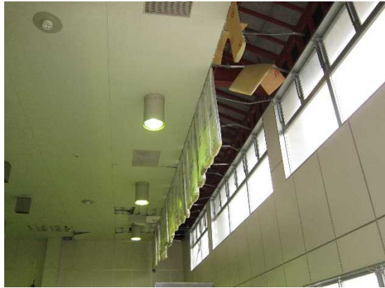
写真5-66 天井面端部での損傷（同）
