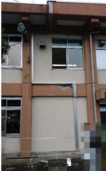
写真 5-51 鉄筋コンクリート造梁のコンクリートの剥離（既存と増築の接続箇所）
