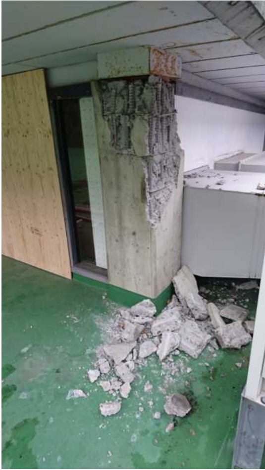
写真 5-46 鉄筋コンクリート造柱の柱頭部の破壊（外部から）
