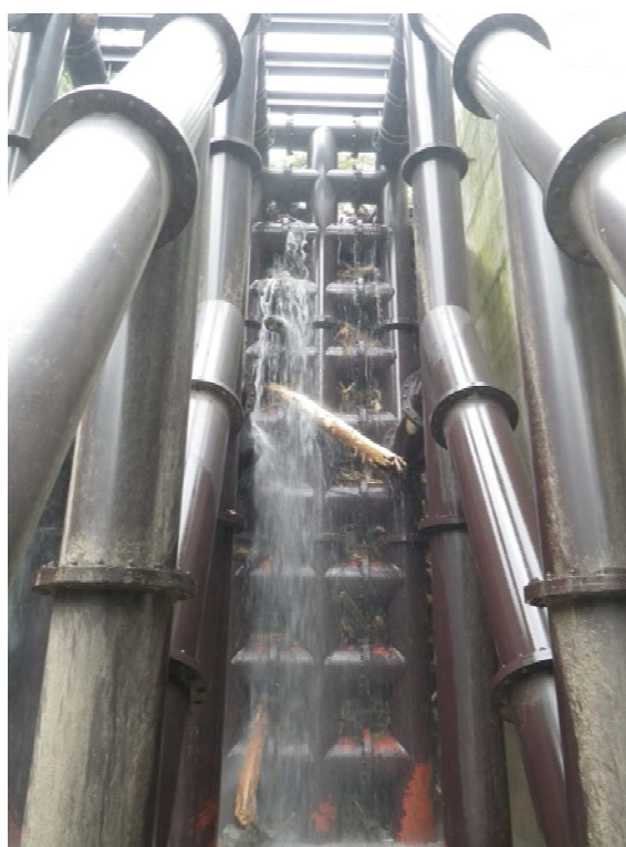
写真. 32 不透過型砂防堰堤スリット部の閉塞状況
