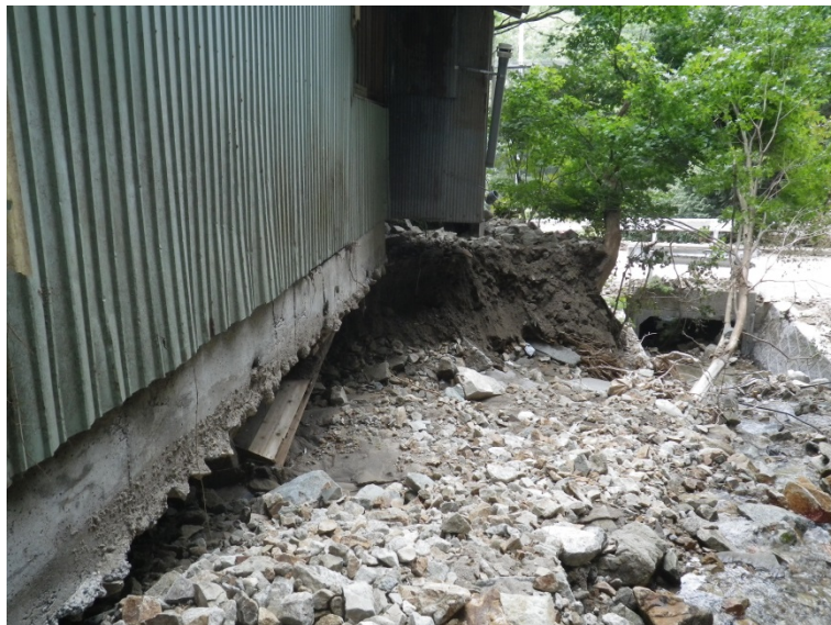
写真. 5 建物基礎の損傷と溪流流末の状況
