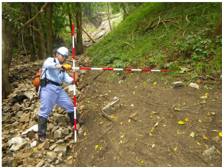
写真. 3 土砂の流下痕跡
