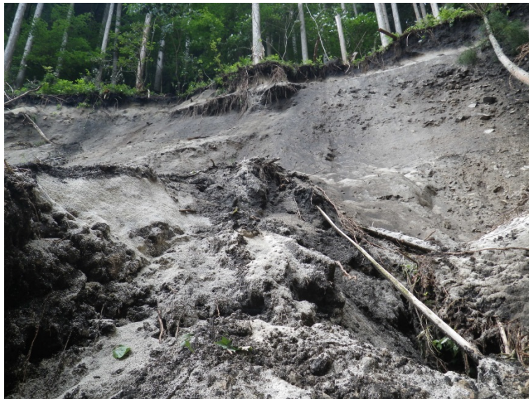
写真. 19 土砂生産源頭部の状況
