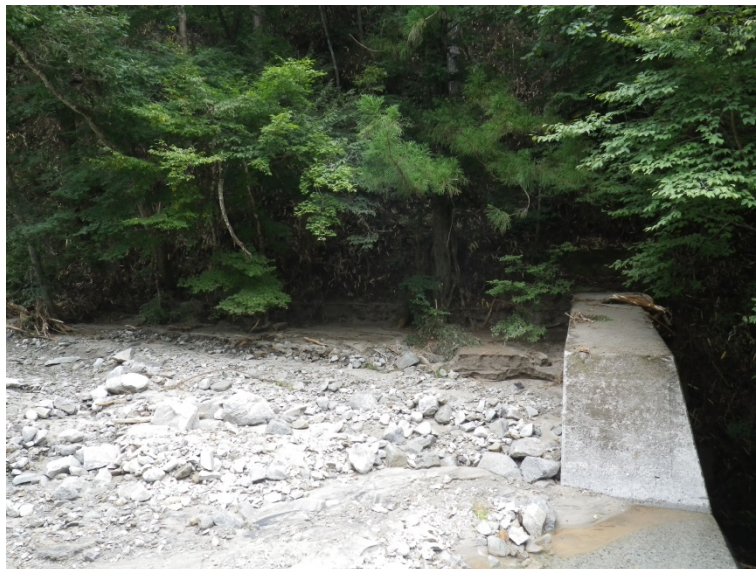
写真. 34 袖裏への土砂堆積と袖を越流した状況
