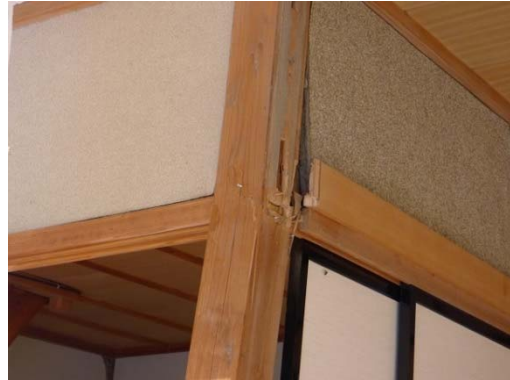
写真 5.3.7 差鴨居部での柱の折損
