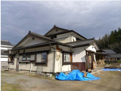
写真 5.3.6 大破した住宅
