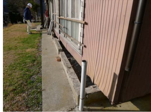
写真 5.3.18 基礎と上部構造のずれ
