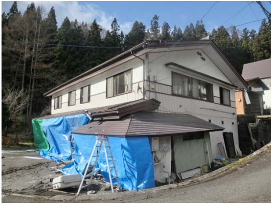
写真 5.2.6 大きく南側に傾いた住宅
