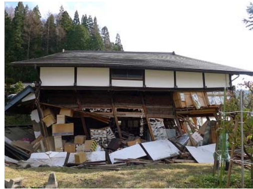
写真 5.1.13 北へ大きく傾いた住宅
