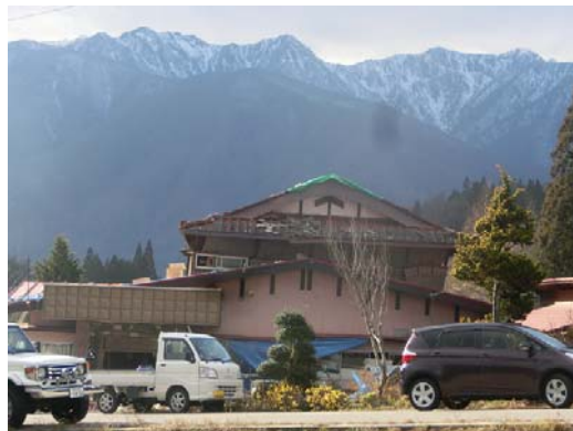
写真 5.2.17 残留変形が大きい住宅
