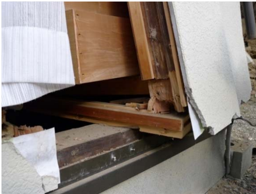
写真 5.3.8 柱の抜け出し
