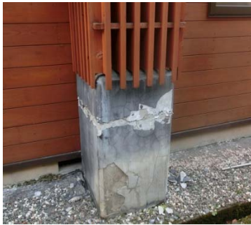
写真 5.2.3 鋼管脚部の損傷
