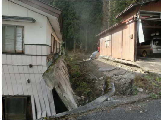
写真 5.2.7 崩壊した北側の擁壁
