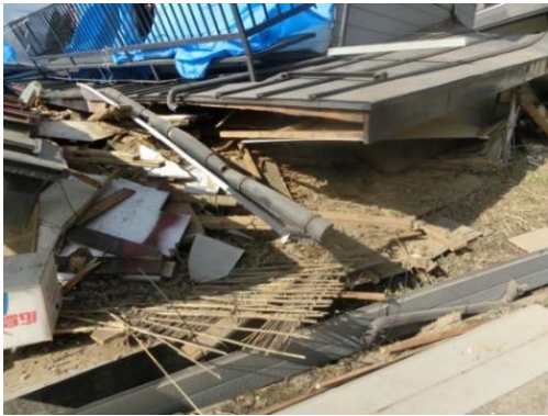
写真 5.1.14 倒壊した住宅の土塗り壁
