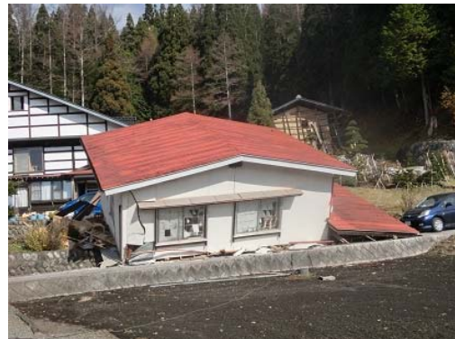
写真 5.1.17 倒壊した納屋併用家屋（手前）
