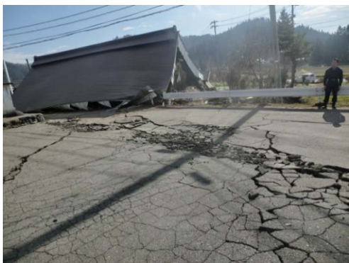
写真 5.1.4 激しく損傷した道路舗装
