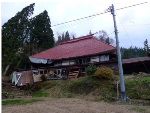
写真 6.1.1 部分的に崩壊した住宅
