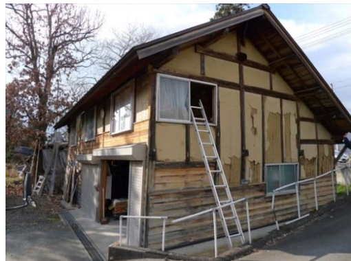
写真 5.3.23 被害を受けた倉庫
