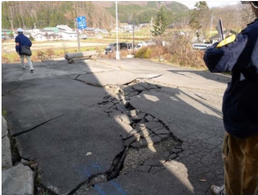
写真 5.3.20 道路の隆起によるひび割れ
