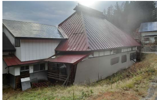
写真 5.2.13 山側への残留変形が大きい住宅
