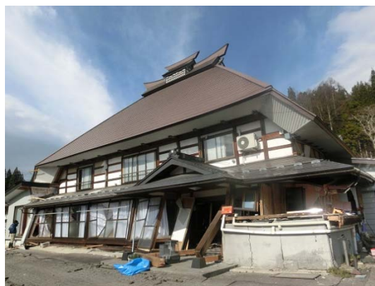
写真 5.1.21 1 階が大破した住宅
