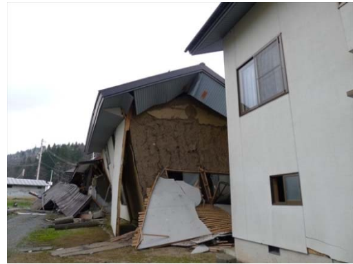
写真 5.3.4 既存部の土蔵の被害
