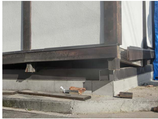
写真 5.2.11 土台を踏み外した柱脚
