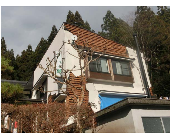
写真 5.2.9 モルタル外壁が剥落した宿泊施設
