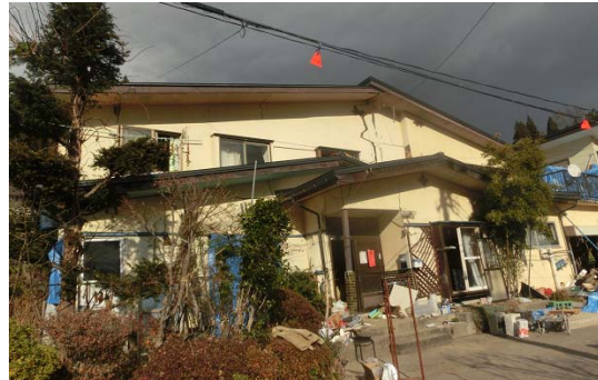
写真 5.2.15 西（写真左）へ傾斜した住宅
