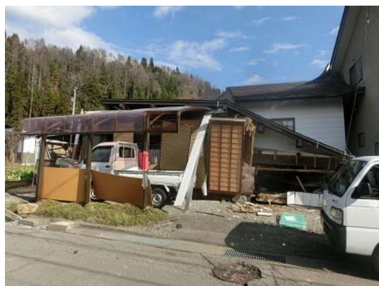
写真 5.1.9 倒壊した住宅
