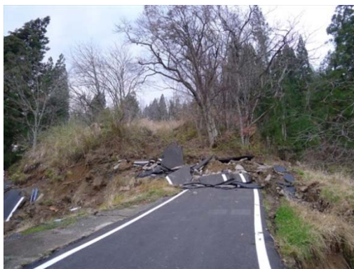
写真 6.1.3 土砂崩れによる道路の被害
