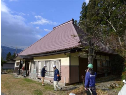
写真 5.3.17 被害を受けた平家の住宅
