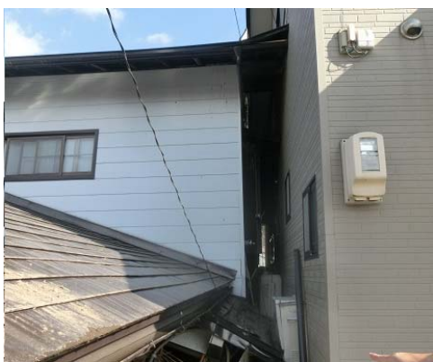
写真 5.1.10 隣家にもたれかかった 2 階部分
