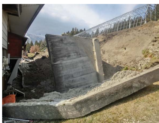
写真 5.1.23 北側の擁壁の崩壊
