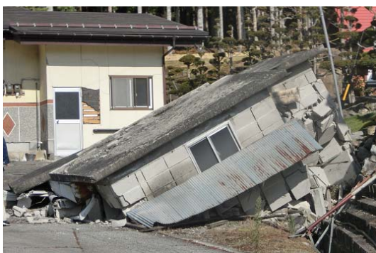
写真 5.1.24 コンクリートブロック造の崩壊
