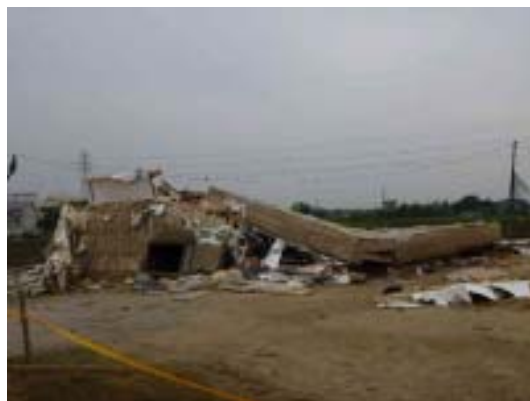
写真 1 転倒した木造建築物
