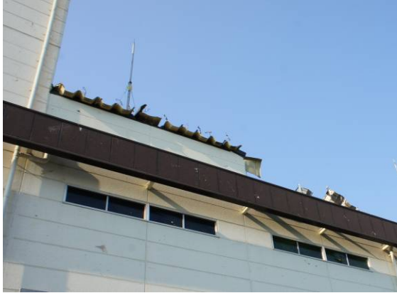
写真 41 屋根ふき材の損傷
