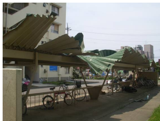
写真 31 駐輪場の折板屋根の著しい変形
