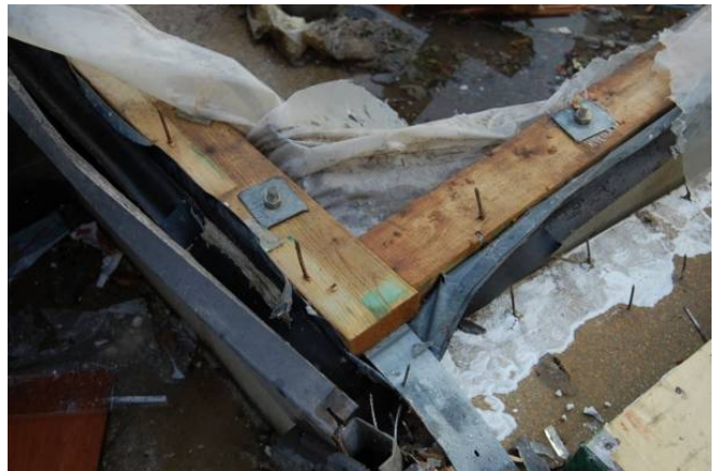
写真 6 木造建築物 D の土台（土台は残存している）
