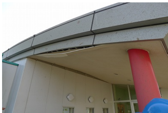
写真 40 軒天井の損傷
