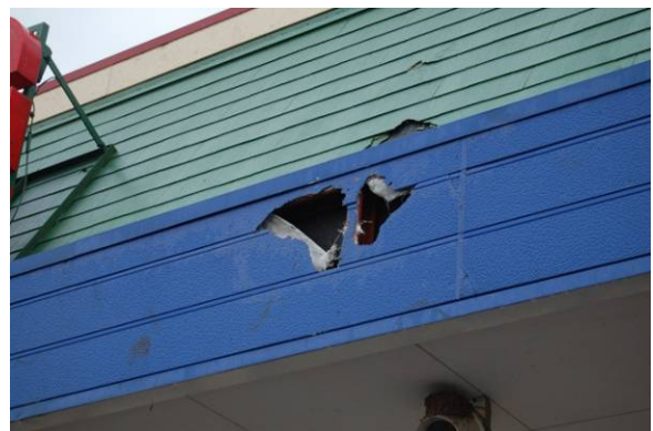
写真 26 外装仕上げ材への衝突痕
