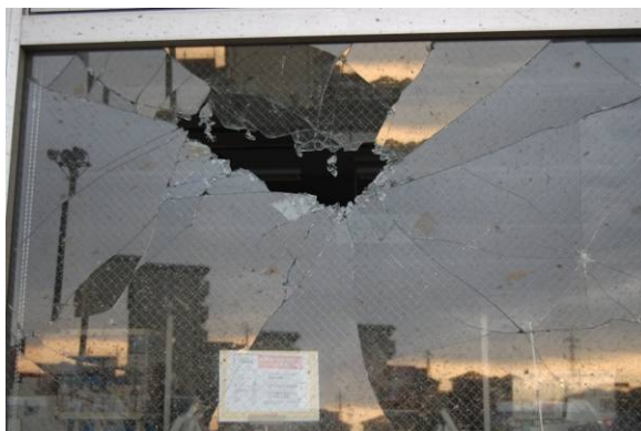
写真 25 窓ガラスへの衝突痕
