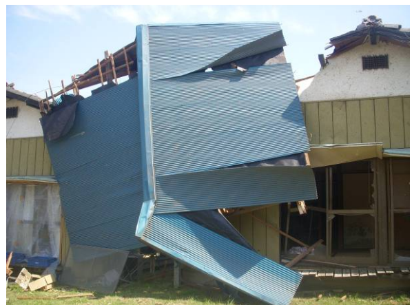
写真 28 飛来物(屋根)の衝突
