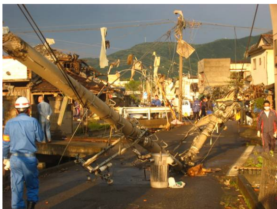
写真 33 電柱の折損・傾斜 1
