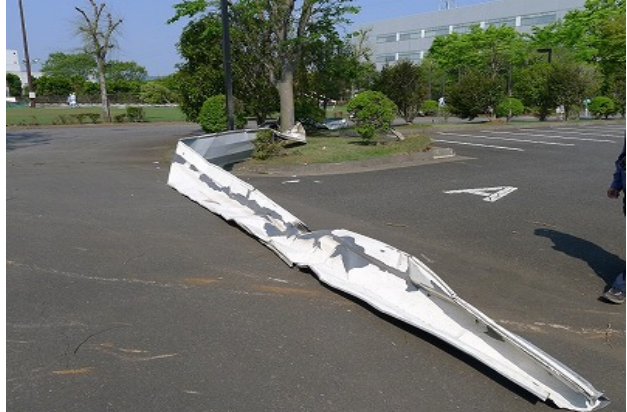
写真 42 飛散した折板
