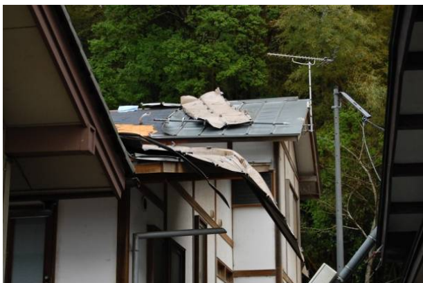
写真 27 飛来物(鋼板製屋根材)の衝突
