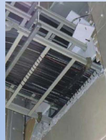
防火区画貫通部の損傷
