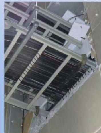
防火区画貫通部の損傷
