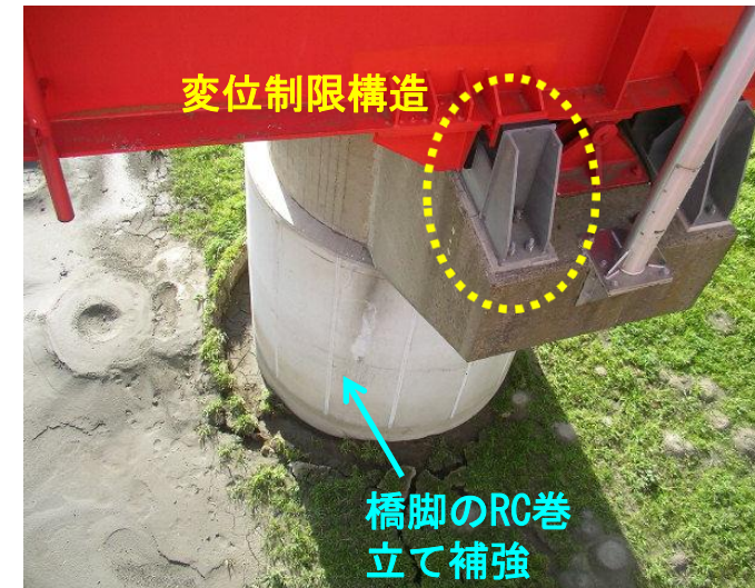
3径間連続橋の固定支承を有する下部構造の変状と周辺地盤の液状化痕跡
