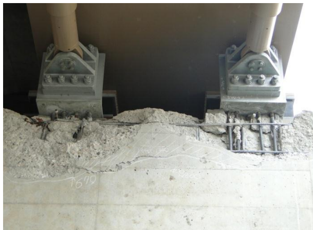
制震装置の取付部周辺の損傷
