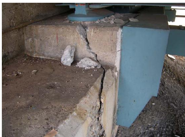
支承取付部の損傷が落橋防止構造の定着機能に影響を与えた事例
