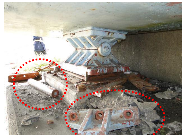
鋼製のサイドブロック、ローラーの破損 → 落下の可能性
