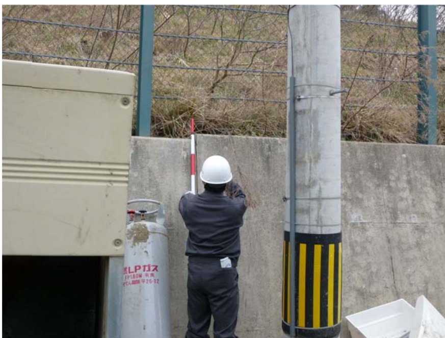
擁壁工に施工目地を挟んで、地震の影響と見られる3cm程度の縦ズレが発生している箇所があった。
