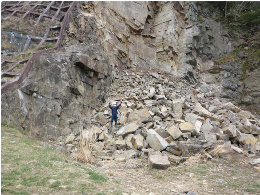
治山事業による法枠の右斜面での崩落 斜面下の人家の住人によると4月7日の地震でも崩落があったとのこと。
