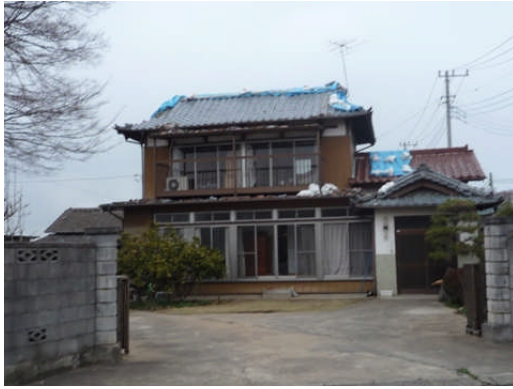
写真 11 常総市上蛇町の屋根瓦の被害
