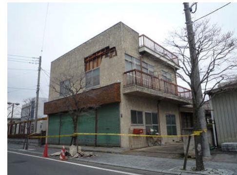
写真 8 鉄骨造建築物の外壁落下
