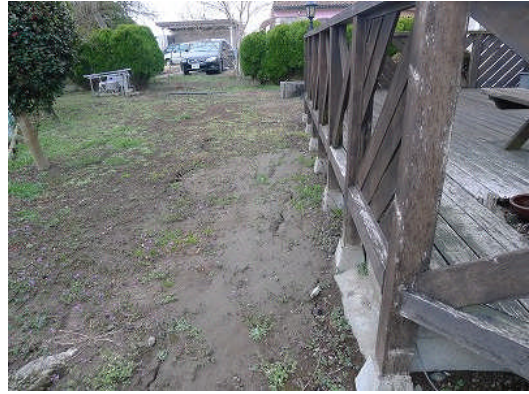
写真 12 液状化による噴砂痕
