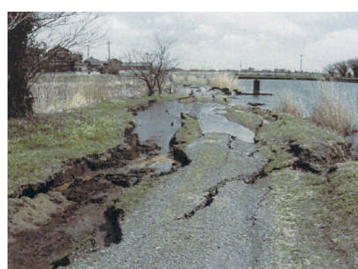
写真 10 レストハウス近辺の地盤の損傷 （常総市提供）
