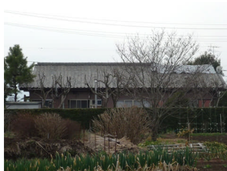
写真 2 屋根瓦の落下（龍ヶ崎市高須町）
