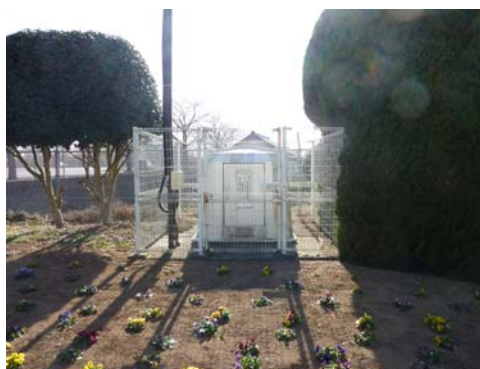
写真 14 K-NET 鉾田の設置状況
