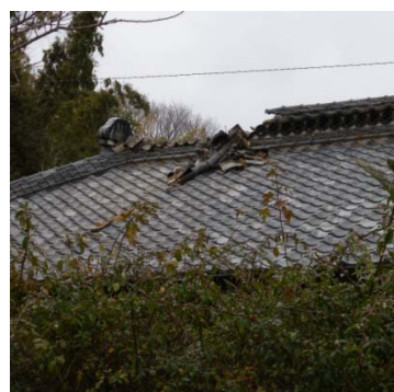
写真8 拡大図 (写真7の○印内)
