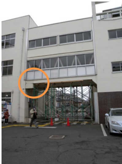
写真 12 使用禁止の渡り廊下
