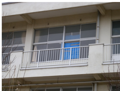
写真2 ガラス窓の脱落（写真1の○印内）
