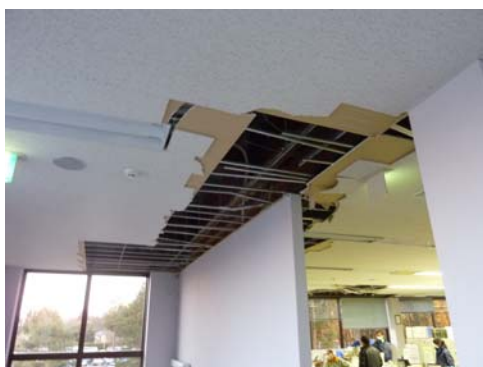
写真 24 付近の建物の天井被害 1
