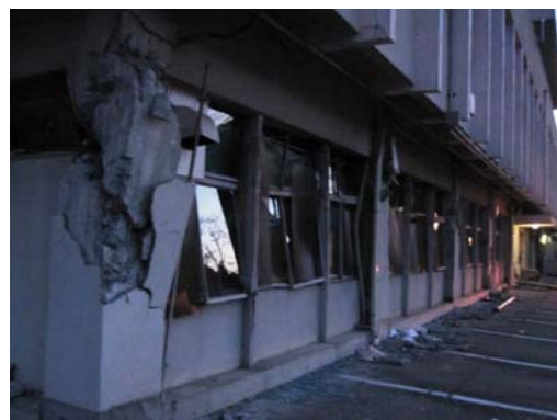
写真 34 外柱のせん断破壊
