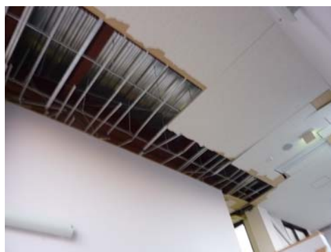
写真 25 付近の建物の天井被害 2
