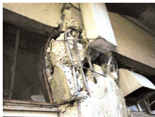
写真 32 極短柱のせん断破壊
