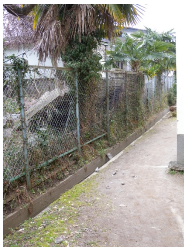
写真3 校舎裏のブロック塀の被害
