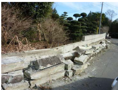
写真 22 ブロック塀の被害
