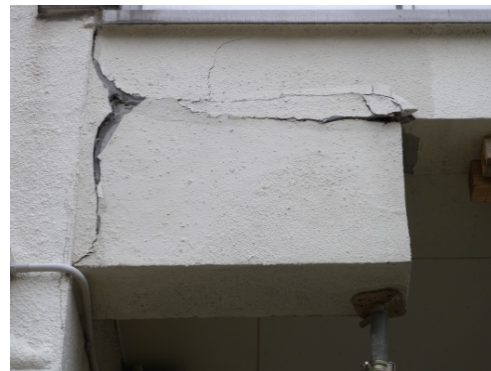
写真 13 支持部分の損傷（写真 12 の○印内）
