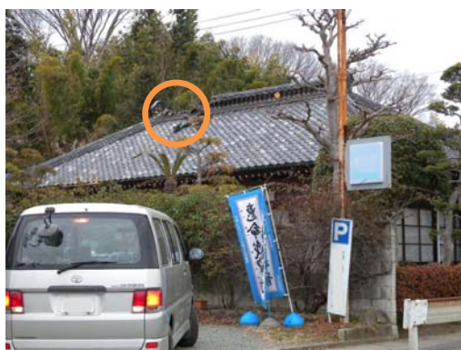
写真7 瓦屋根の被害
