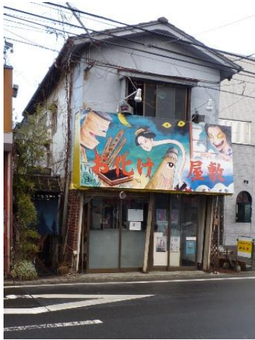
写真 47 残留変形の大きな木造 (仙台市青葉区小松島)
