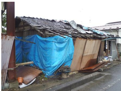
写真 18 老朽化した家屋の倒壊
