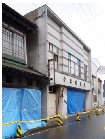
写真 22 商店建築物の被害
