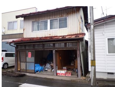
写真 15 町屋形式の住宅の被害
