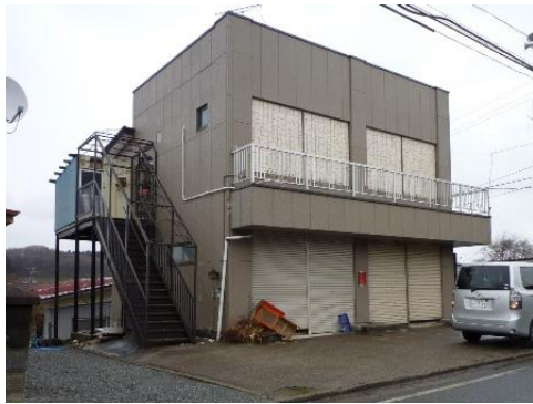
写真 39 鉄骨造建築物の被害 (栗原市瀬峰)
