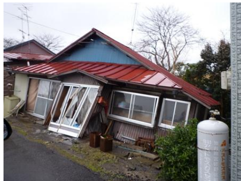
写真 13 地盤変状によると見られる被害
