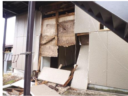
写真 40 写真 39 の外壁の破壊状況 (栗原市瀬峰)
