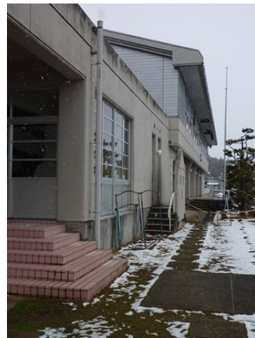
写真 32 写真 31 の軒天井の脱落 (栗原市栗駒)
