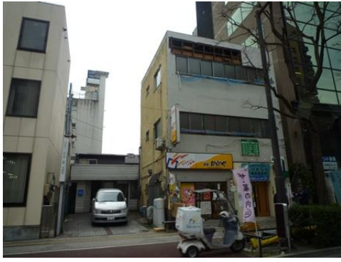
写真 1 鉄骨造建築物の外壁仕上げ剥落 (仙台市街)
