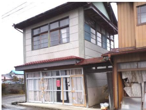
写真 16 町屋形式の住宅の被害
