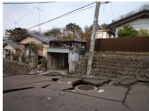
写真 5 道路の路面破壊 (青葉区折立 5 丁目)
