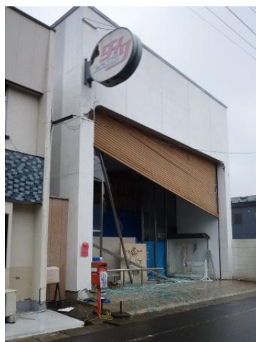
写真 23 鉄骨造と見られる建築物の被害
