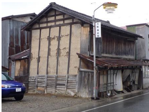
写真 14 町屋形式の住宅の被害
