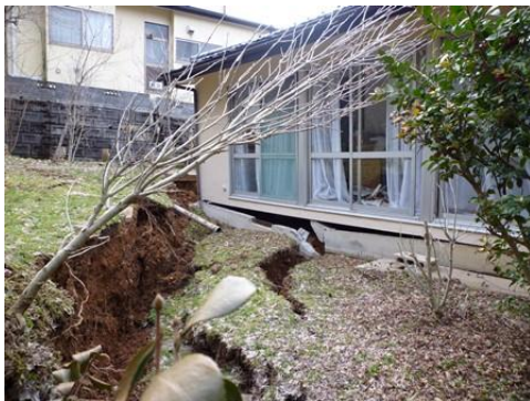
写真 4 写真 3 の住宅、基礎が 90cm 程度沈下 (青葉区折立 5 丁目)
