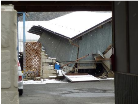
写真 27 作業小屋の倒壊 (栗原市栗駒桜田)
