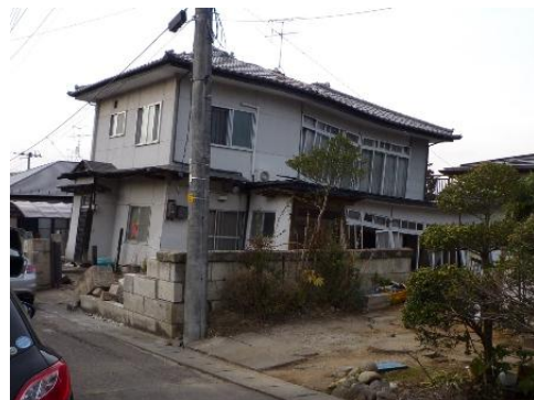
写真 7 地盤変状に伴う住宅被害 (青葉区折立 5 丁目)
