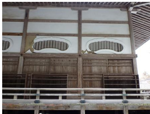
写真 9 中尊寺本堂 土壁の剥落
