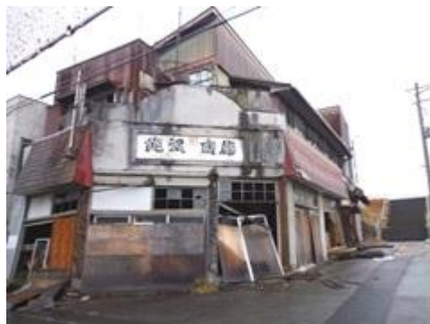
写真 21 老朽化した商店建築物の被害
