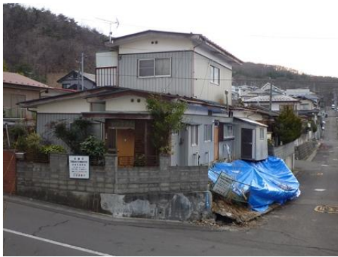
写真 2 擁壁破壊と住宅被害 (青葉区折立 6 丁目)
