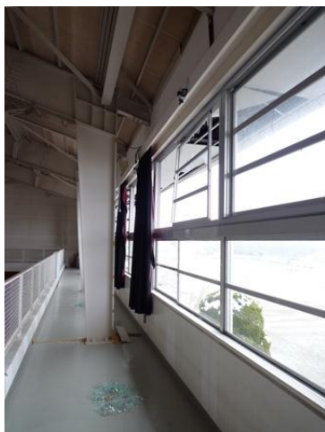
写真 33 写真 31 の窓、軒天の被害 (栗原市栗駒)
