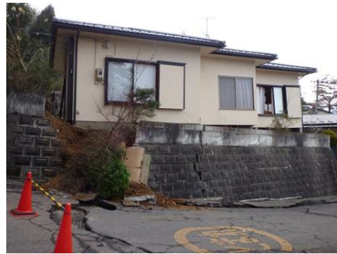
写真 3 擁壁破壊と住宅被害 (青葉区折立 5 丁目)
