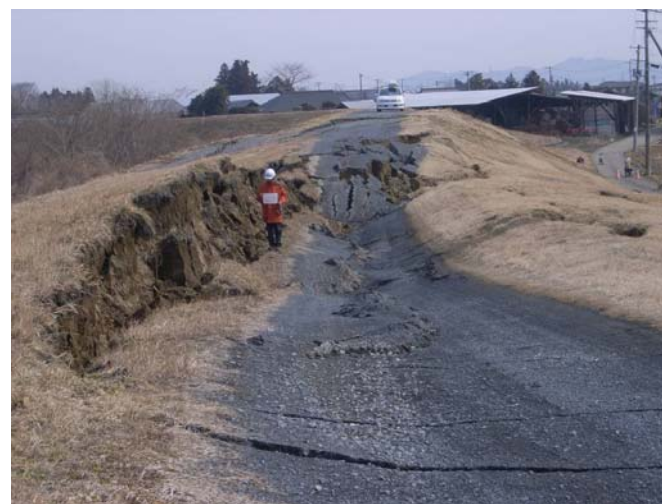
◆堤防天端が2m 程度陥没。堤外側（写真右）に向かう側方移動あり
