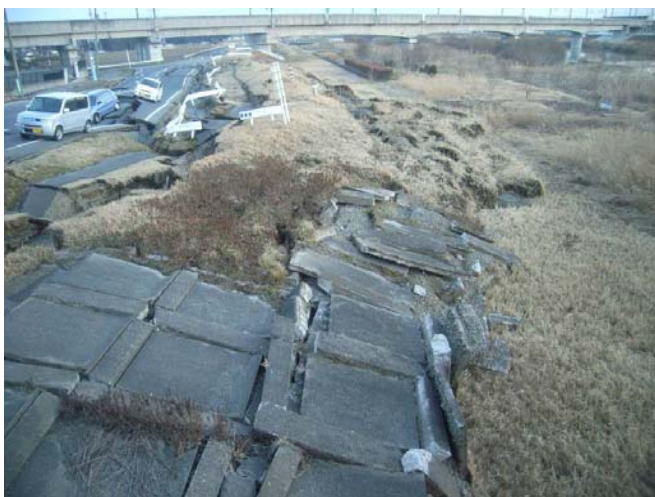
◆堤外側のり尻が側方へ移動・変形
