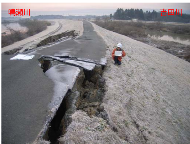
◆堤防天端が吉田川側に陥没
