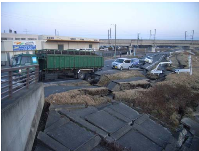
◆車両が載ったまま天端が大きく陥没。のり肩部にクラックが発生。
