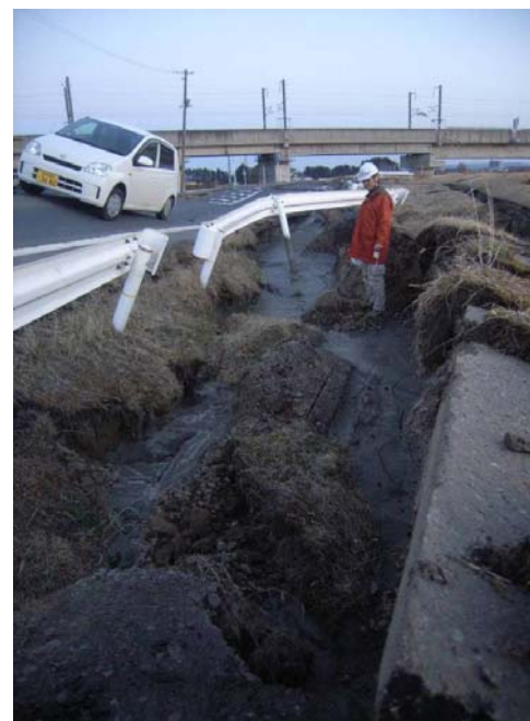
◆クラック内には液状化によると思われる高含水の砂（青灰色）が充填されていた
