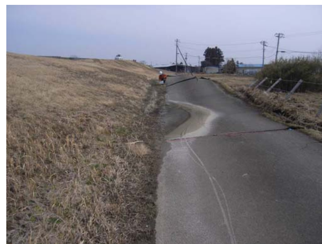
◆側方移動に伴うのり尻部道路の変形。路面に高含水の砂（青灰色）が噴出
