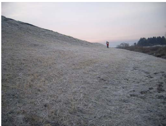
◆調査員の周辺：のり面が凹み、勾配が緩くなっている
