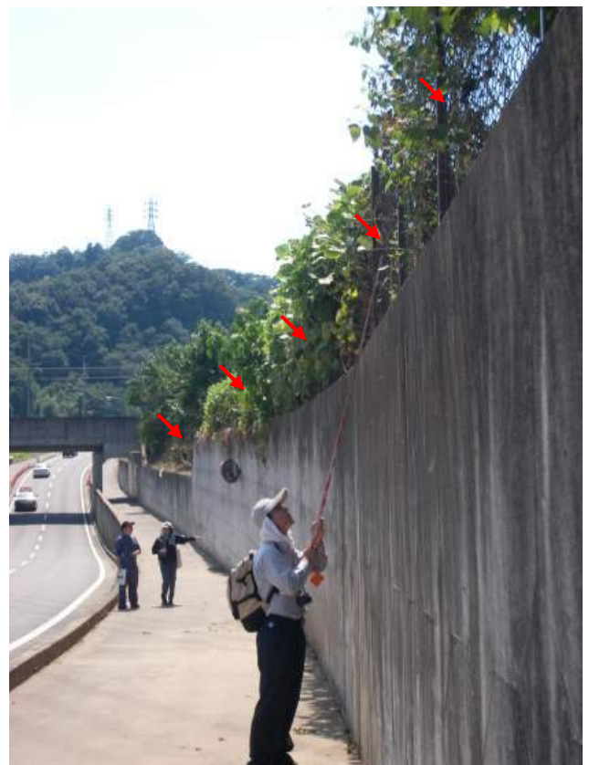
写真9 アンダーパス上流側痕跡
