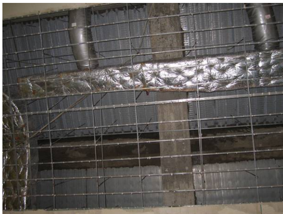
図 12 変色、水跡、結露の様子
