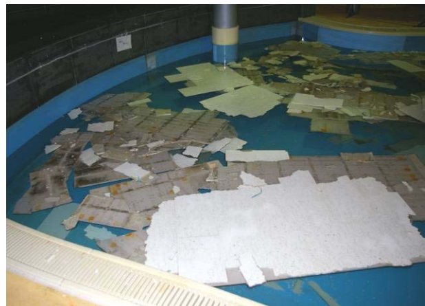
図7 脱落した天井板（プール2）
