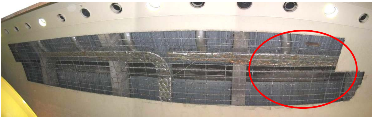
図4 天井板脱落箇所（パノラマ合成。図3内矢印方向見上げ。円内は一度目の脱落箇所）
