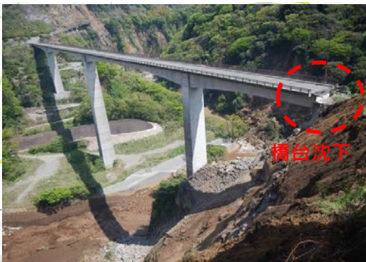
阿蘇長陽大橋の被災状況
