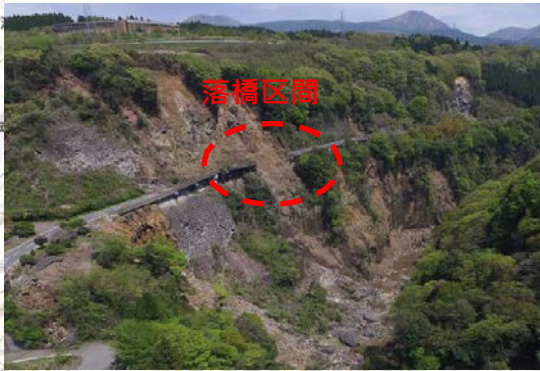
戸下大橋の被災状況
