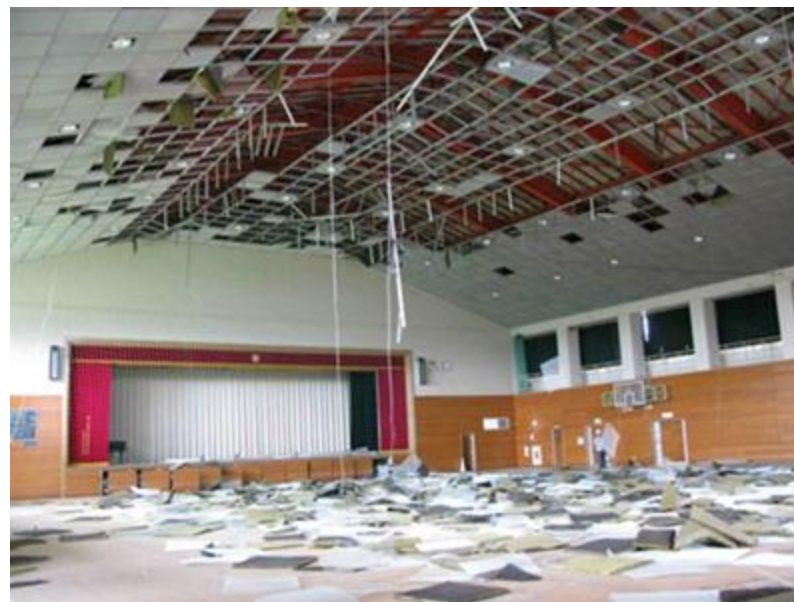
体育館(システム天井)の被害
