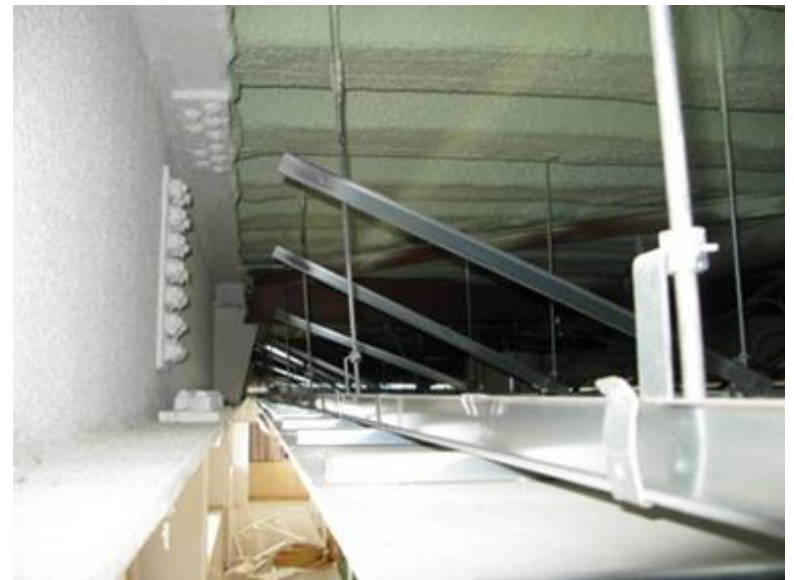
斜め部材の溶接部の破断
