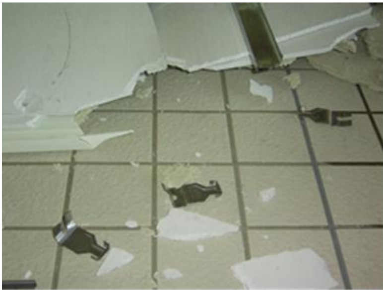
クリップの損傷・外れ
