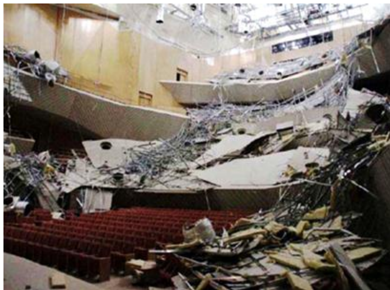
大規模ホールの被害 (坂本功氏提供)
