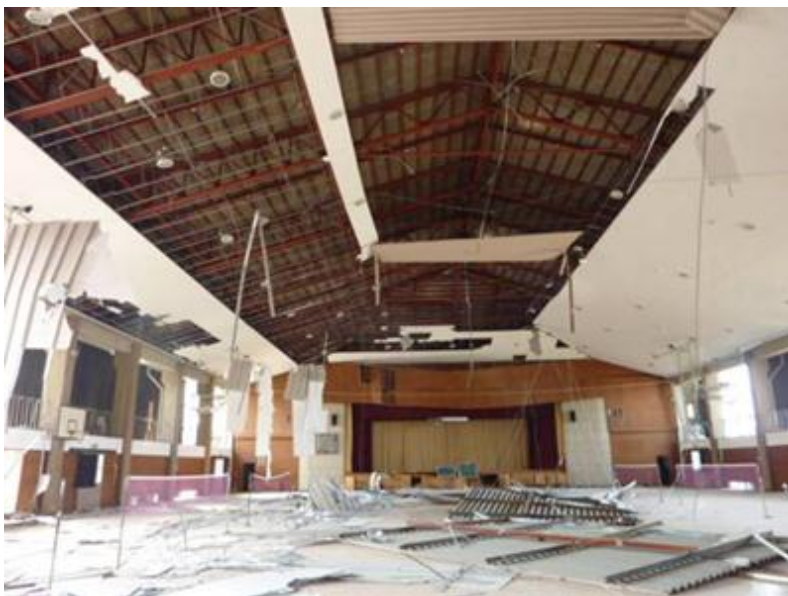
体育館(在来工法の天井)の被害
