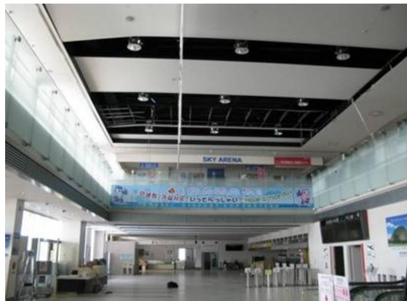
空港ロビーの被害
