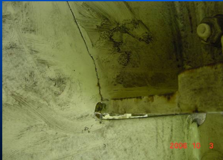
主桁亀裂位置(外側)
