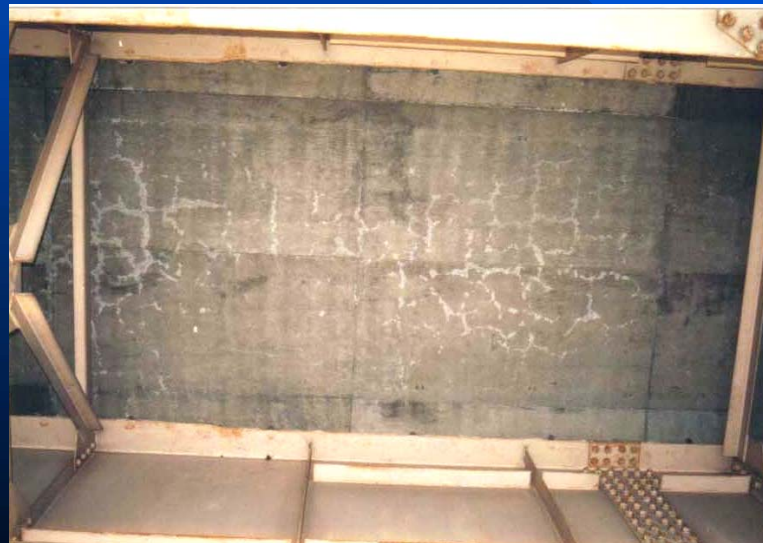
遊離石灰を伴う格子状ひびわれ
