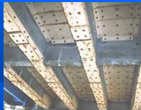
【主桁補強材の再劣化事例】
