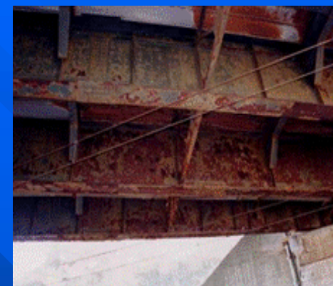
鋼部材の腐食
