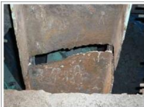
斜材の破断(1箇所)
