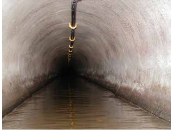
写真 3 下水管に設置された光ファイバー
