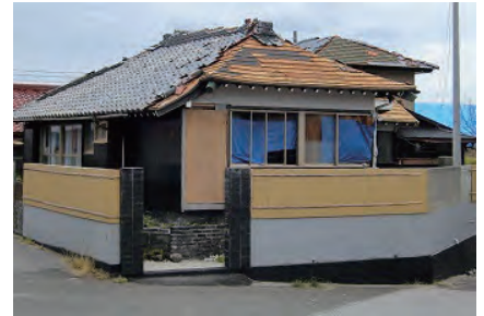
台風による瓦屋根の被害例 (令和元年台風第15号)
