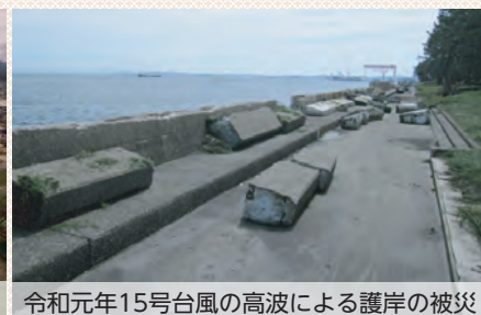
令和元年15号台風の高波による護岸の被災
