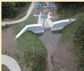
土砂・流木捕捉効果の高い砂防堰堤を整備（長野県須坂市）
