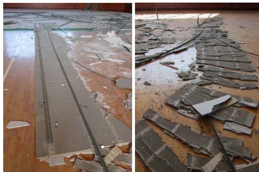
脱落した天井部材
