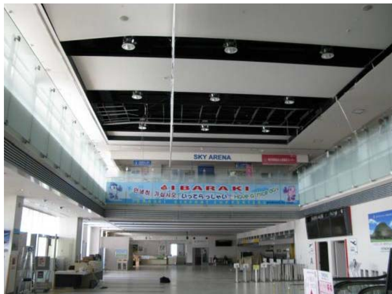
旅客施設における天井の脱落
