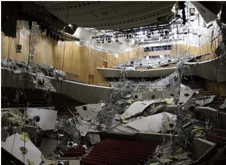
音楽ホールにおける天井の脱落
