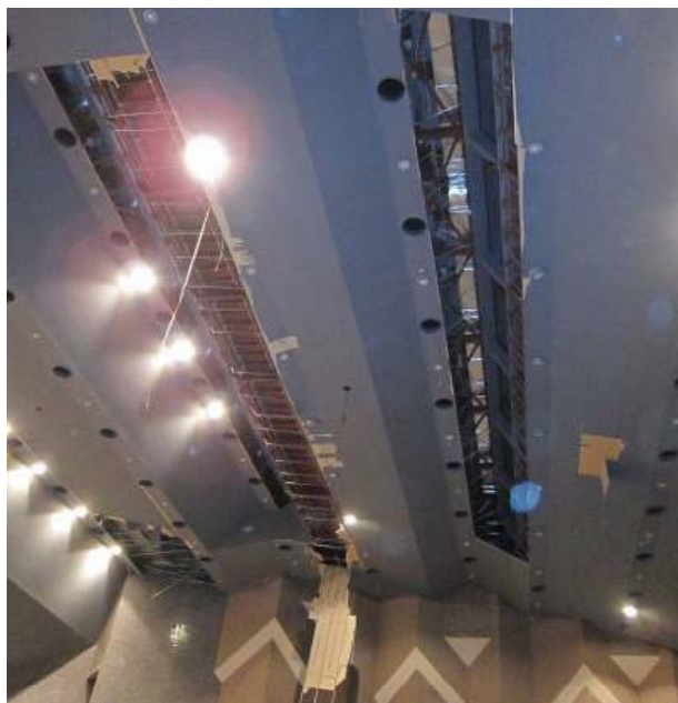
ホールにおける天井の脱落
