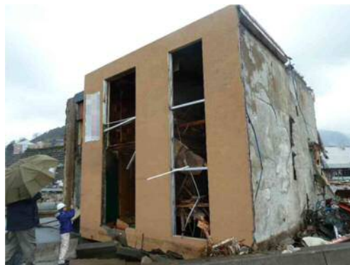
写真 2.1 転倒したRC造建築物
