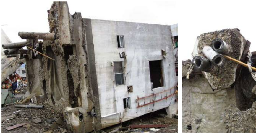
写真 2.2 転倒した杭基礎鉄筋コンクリート建築物 (OG-09)
