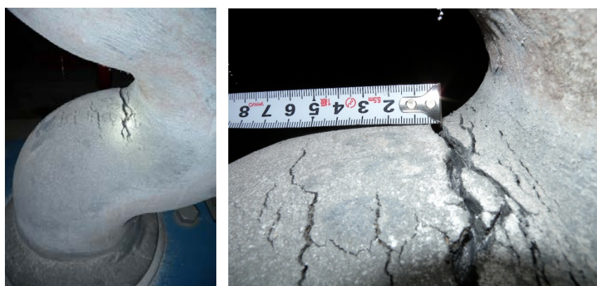
写真1 鉛ダンパーの亀裂及び拡大図（C）
