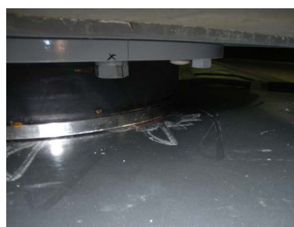
写真5 弾性すべり支承のすべり面のきず（L）
