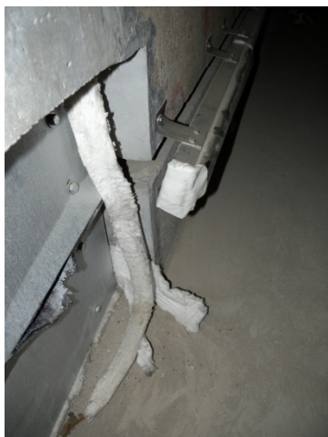
写真10 目地充填材のずれ（A）
