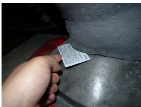
写真2 鉛ダンパーの亀裂（I）
