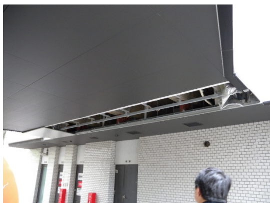
写真8 天井部カバーの脱落（A）
