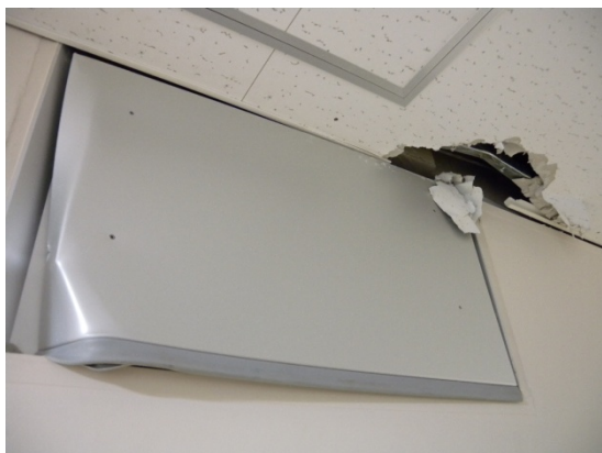
写真6 カバーの破損（A）
