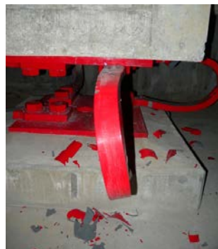
写真3 鋼材ダンパーの塗装の剥がれと残留変形（L）
