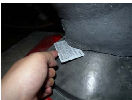
写真2 鉛ダンパーの亀裂（I）
