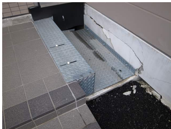
写真7 スライド部の破損 (J)
