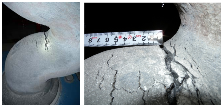
写真1 鉛ダンパーの亀裂及び拡大図（C）
